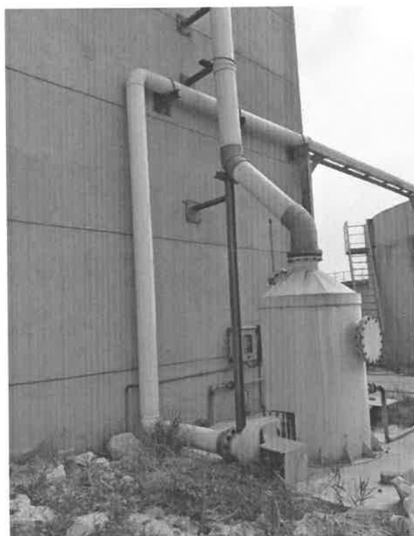
生物滤池除臭系统
