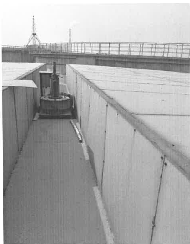
加盖收集装置
